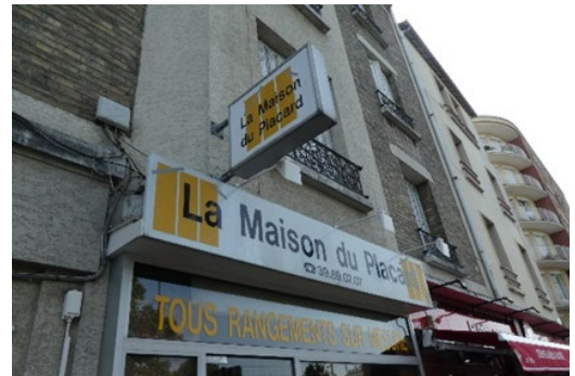
Enseigne mal implantée sur la façade
